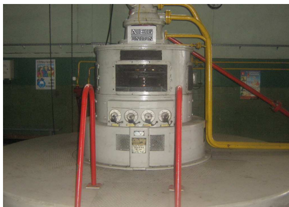
Fot. 4. Widok prądnicy wzbudzającej generatora
